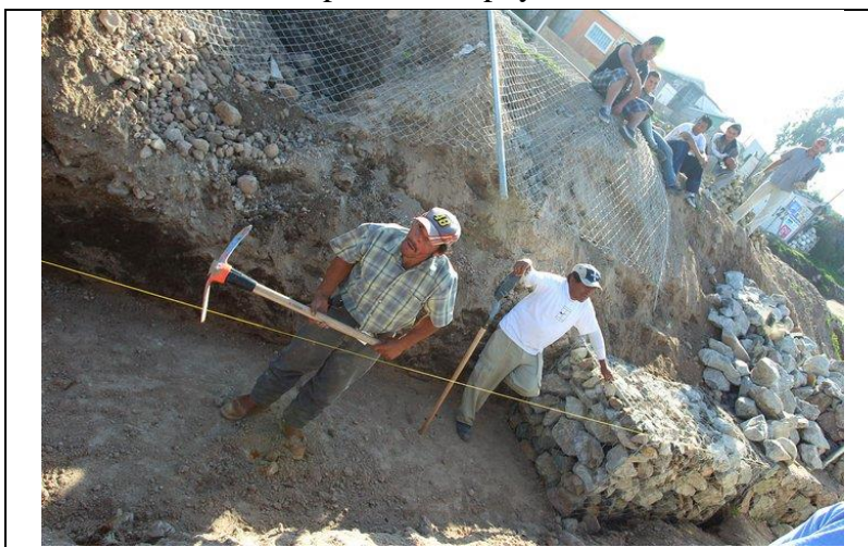
IMAGEN 7. Muro de contención construido con participación de residentes del Altiplano con apoyo del PET
