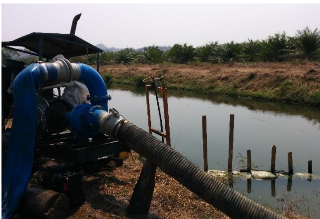
Fotografía 12: Motobomba sacando agua de canal de riego. Al fondo, trinchas en la compuerta del canal y palma de aceite. María la Baja. Rendón, 2016.
