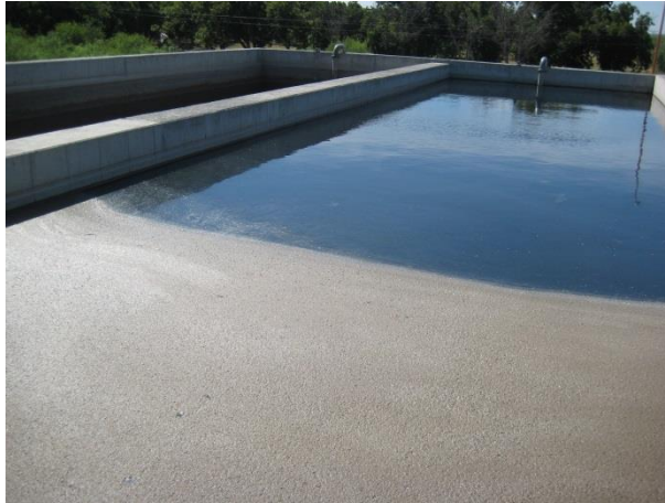
Fotografía 15. Digestión de lodos en el tanque de retención de lodos.
