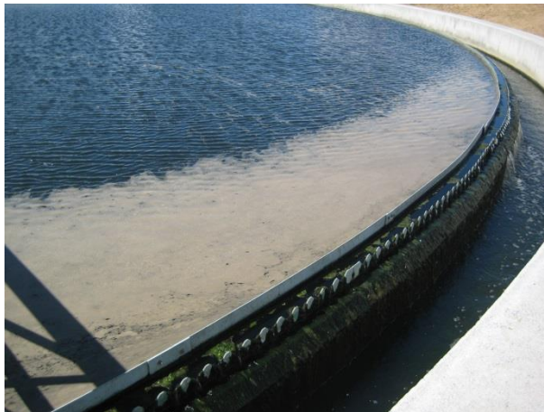
Fotografía 10. Materia flotante en los clarificadores
