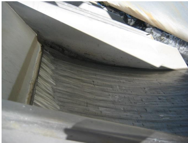
Fotografía 4. Rejillas de remoción de arena
