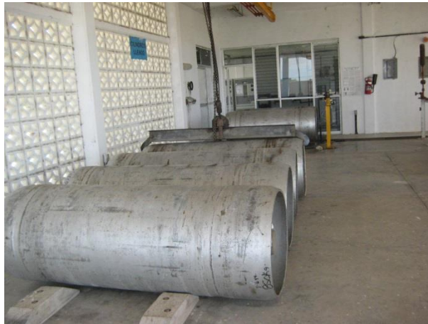
Fotografía 12. Estación de cloración
