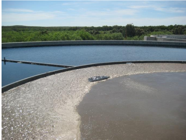
Fotografía 9. Ingreso del caudal a los clarificadores
